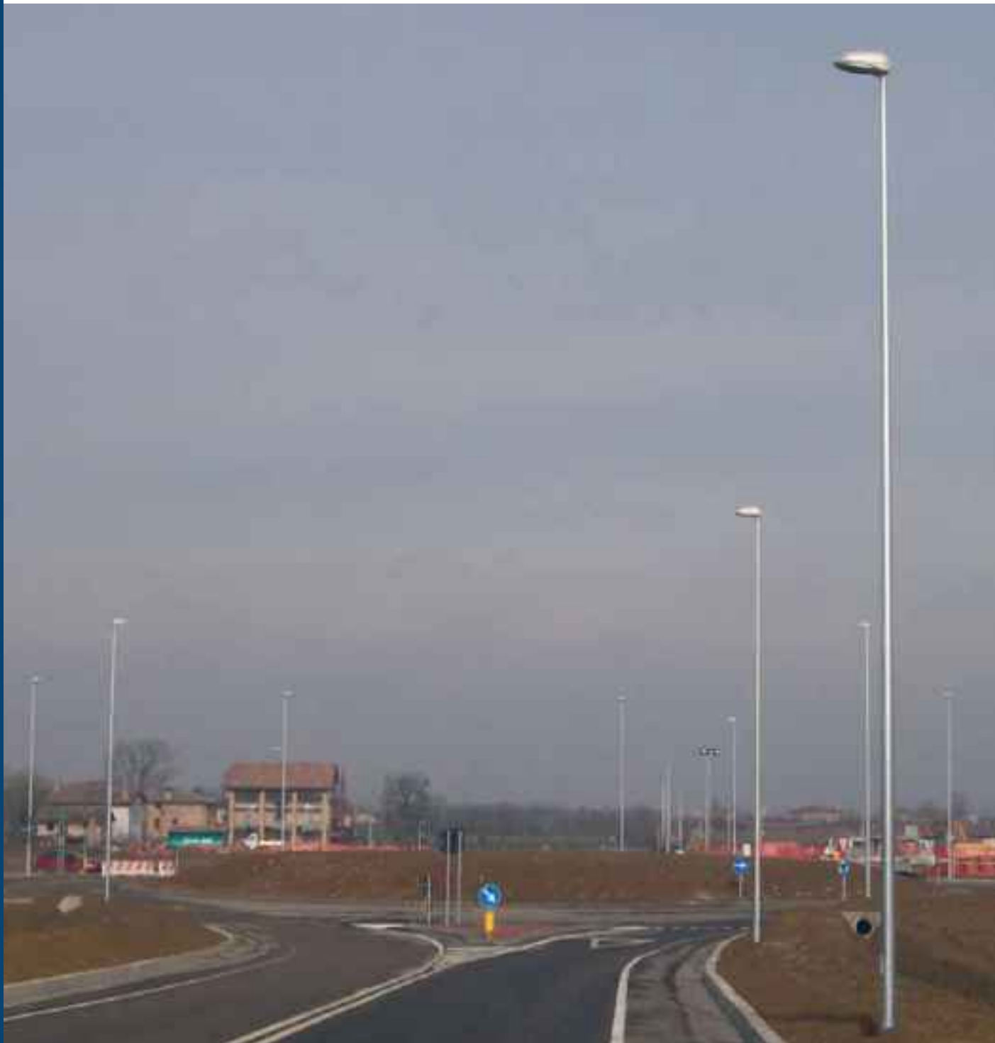
Installazione VIP-2 • Provincia di Modena
