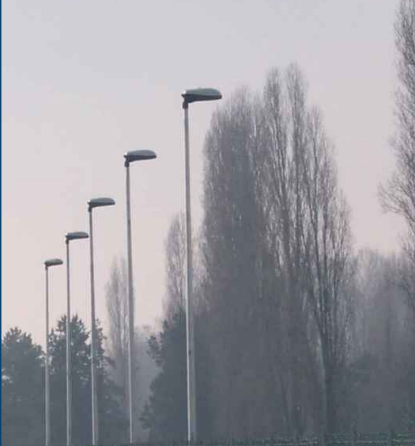
Installazione SMART-150 • Provincia di Bologna
