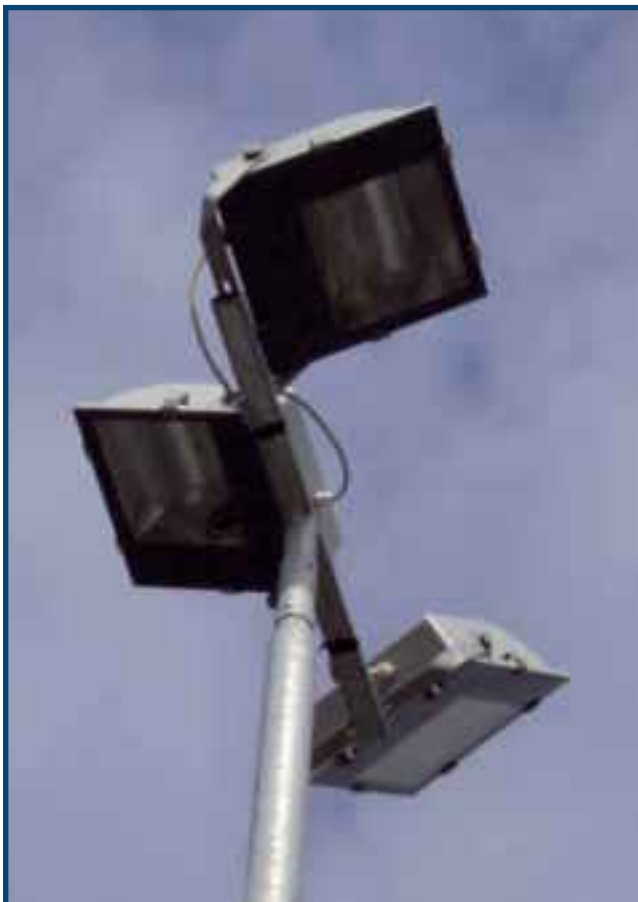
Installazione LUX150-S - Area di servizio Prenestina Sud
