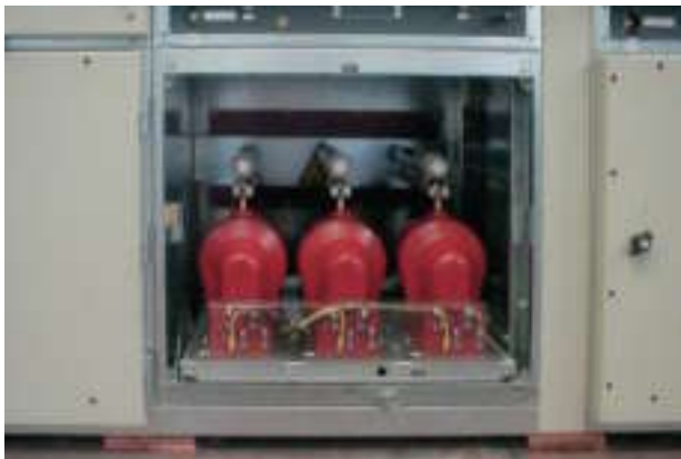
cella TV in posizione di sezionato. VT cubicle in disconnected position.
