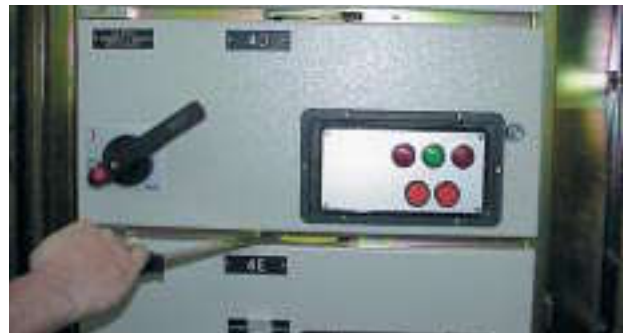
cassetto in posizione di prova drawer in test position
