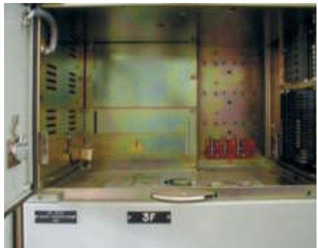
cubicolo attrezzato fitted cubicle
