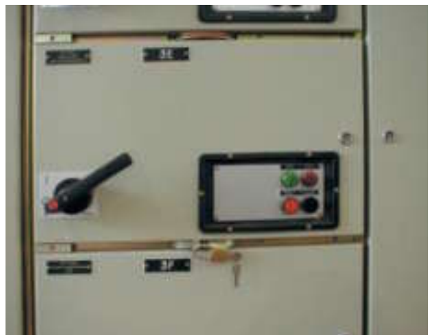
blocco manovre con lucchetto set of circuit breaker handle with lock
